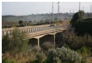
MA110 - Il ponte sul Molinello della strada da cui si accede al sito: visibili la masseria e il Petrolchimico
