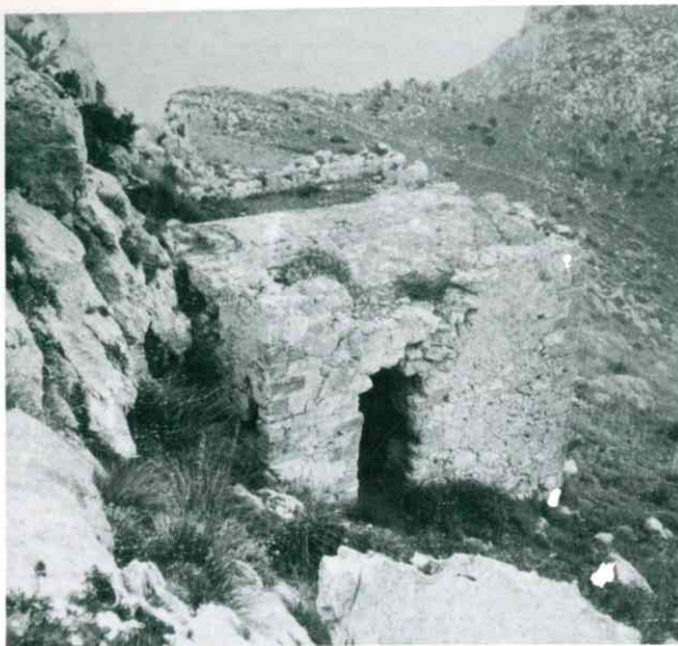
Fig. 8 - Dammuso di Gallo: le precarie condizioni della torre posta a ridosso della cortina di rocce e dello strapiombo del Malopasso.
